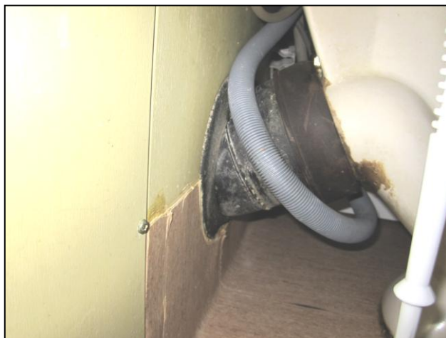
WC-istuimen kytkentäputki PE-muovia.
