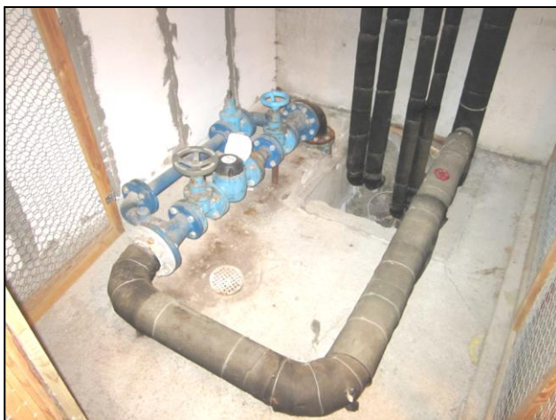
Vesimittari, ei havaittu vakiopaineventtiiliä.
