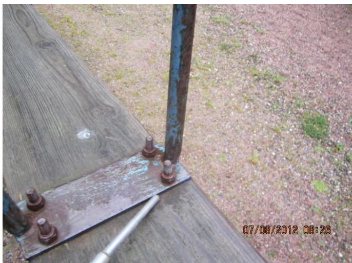
Mutterinsuojat puuttuvat ** Asenna mutterinsuojat
