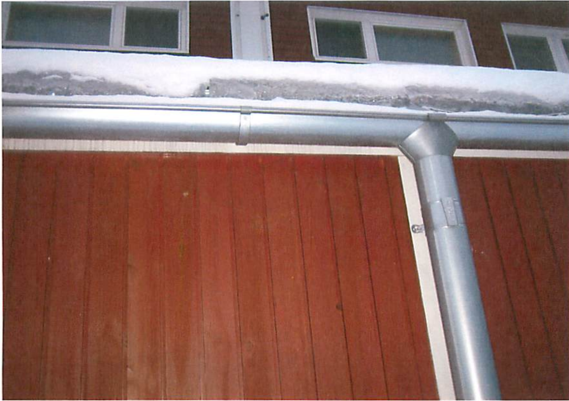
Kuva 7. Huoneiston ulkovarastossa on lämmitin, jolloin katolle kertyy runsaasti jäätä.
