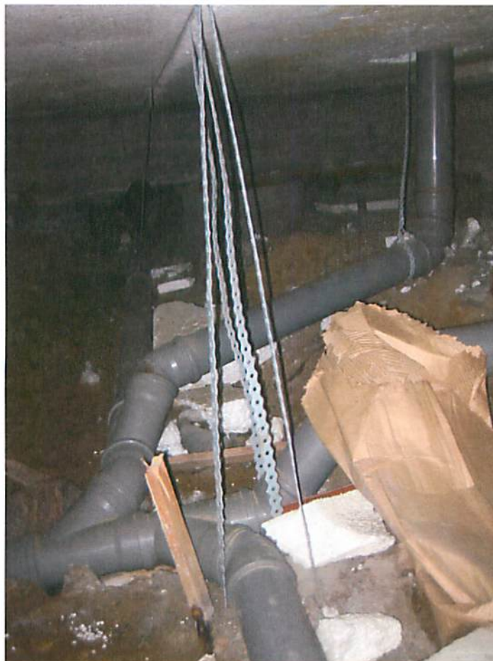
Kuva 6. Alapohjan viemäriputkustuksia ja rakennusjätteitä.
