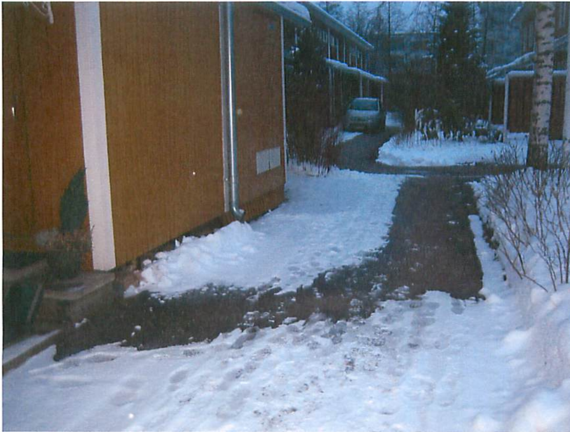
Kuva 5. Lämpökanaaleissa on lämpövuotoa.
