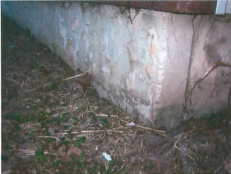
Kuva 3 Sokkelin pinnoitteet on paikoin irti ja sokkelit ovat ruman näköiset.
