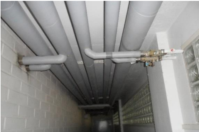
Kuva 1. Käyttövesi ja lämmitysputket kulkevat pohjakerroksen katossa.
