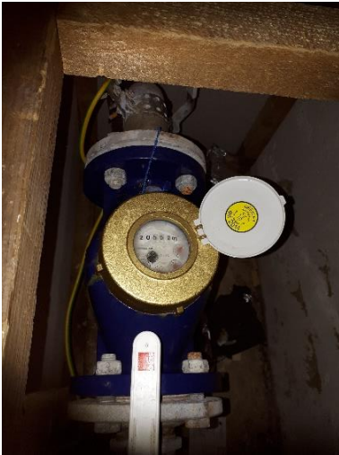
Kuva 3. Alkuperäinen tonttivesijohto ja vesimittari kellarikerroksen varastotilassa.
