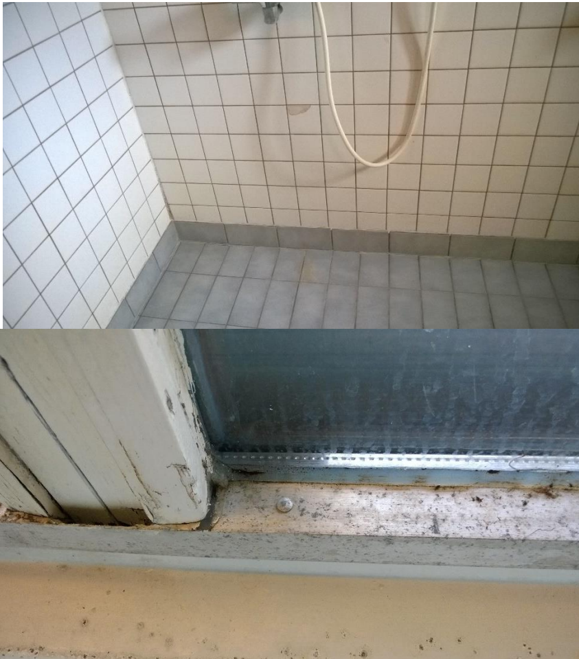
Kuva 12. suihkutilassa haljenneita laattoja ja allashuoneen ikkunoissa rakenteellisia vaurioita.
