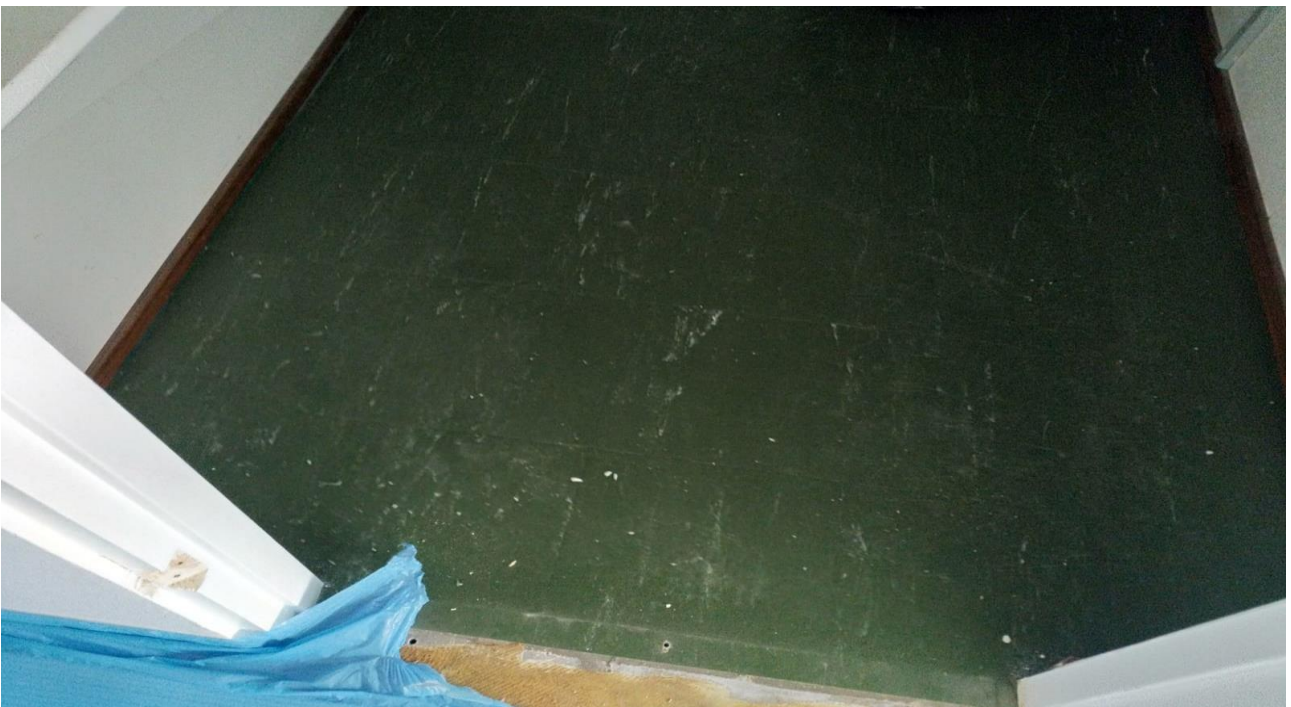
Vaatehuoneen vinyyliä liimoineen sisältää asbestia. Samaa vinyyliä on toisessakin vaatehuoneessa.
